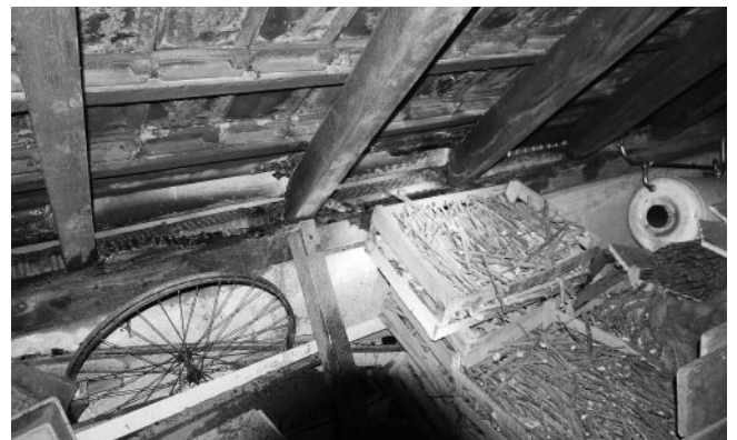
Angrenzende Scheune mit Spuren der Brandausbreitung
